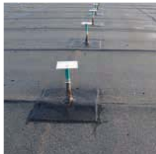
Ripristino della guaina tramite fissaggio a caldo di nuova membrana bituminosa Sheath re-establishment by heat fixing of a new bituminous sheath
